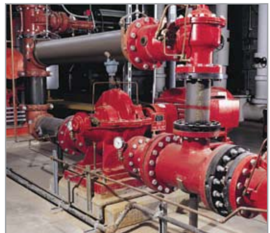
Instalación segura y protegida.
