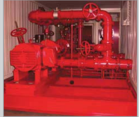
Unidad completa en una cubierta.
