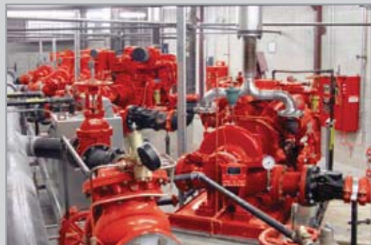
Bomba de incendio horizontal de carcasa dividida con motor diesel.
