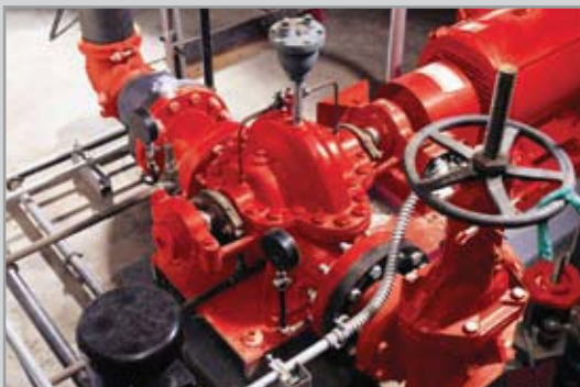
Bomba de incendio horizontal de carcasa dividida con motor eléctrico.
